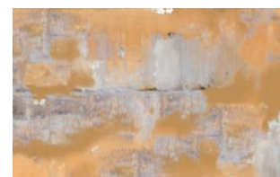
7442 Verwitterte dunkle Fassade
