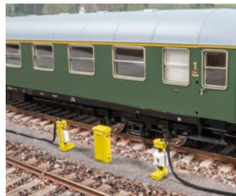
H0 13612 Zugvorheizanlage Steuersäule, Sollbruchstellen, Blinddosenständer
